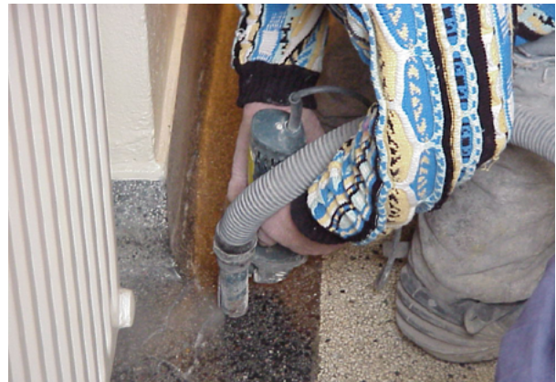
Onjuist geplaatste afzuiging kan in de weg zitten.
