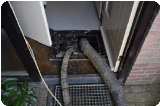
Figuur 4.3 - Het afzuigen/ventileren van de kruipruimte tijdens het werk. Probeer bij deze werkzaamheden zo weinig mogelijk valse lucht aan te zuigen.
