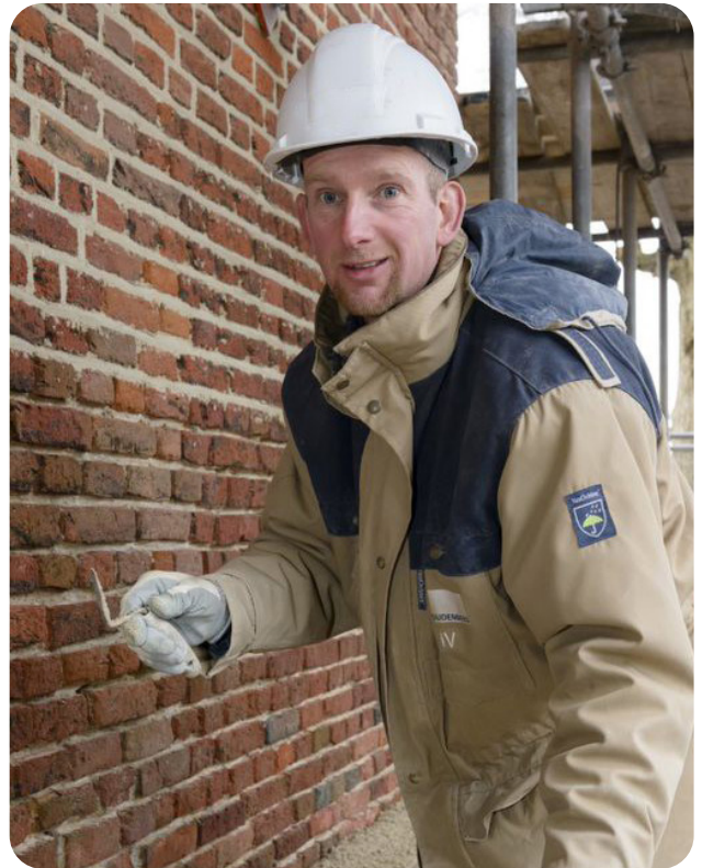
Afbeelding 2: Voeger aan het werk op een steiger die strak tegen de gevel gelegd is. Hierdoor kan specie niet langs de gevel naar beneden vallen en worden schoonmaakwerkzaamheden voorkomen.
